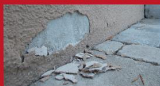
Schadhafter Oberputz im Sockelbereich
